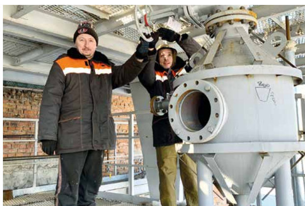
На снимках: Идет монтаж и наладка технологической линии по производству экологичного гранулированного полукокса и бездымного топлива из рядового угля
